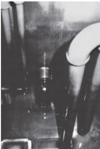
壁面、配管内部に多量に付着している酸化変質物
